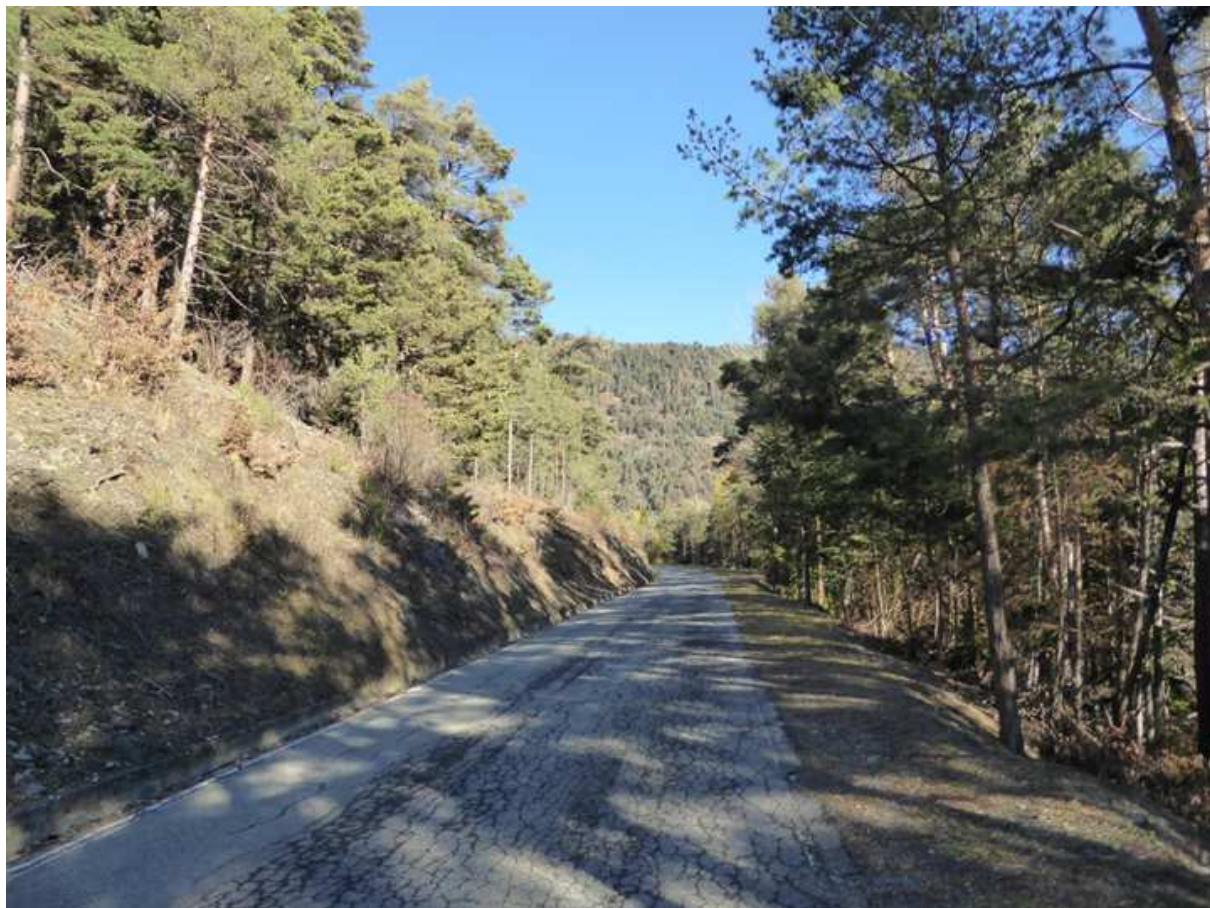
Immagine 15 - Comune di Sarre, strada regionale n°41 «dei Salassi». Intensità di attacco è molto bassa
